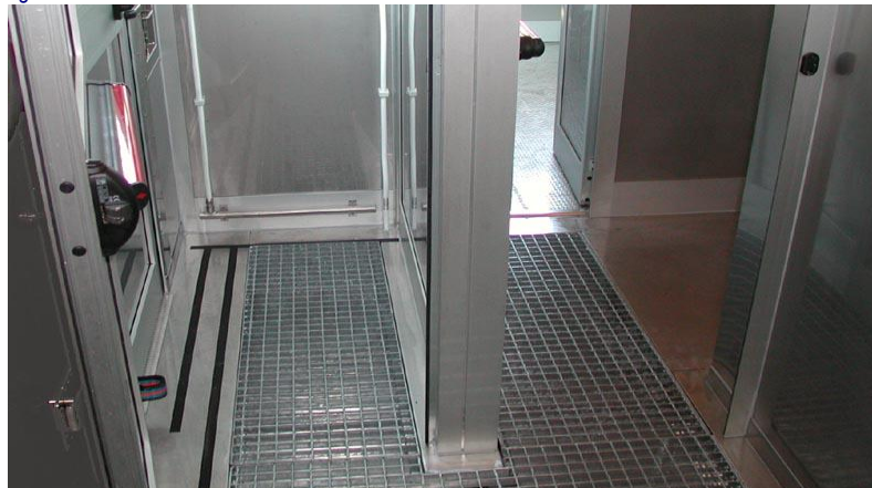
Innenraum-Detail Benutzer-Durchgangsbereiche mit gittergeschützten Wannen
