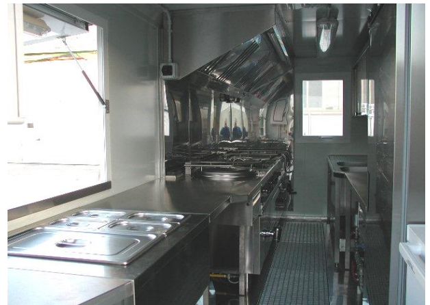
Vista interior del conjunto desde la puerta de entrada: a la izquierda el lado cocción distribución a la derecha el lado fregadero frigoríficos
