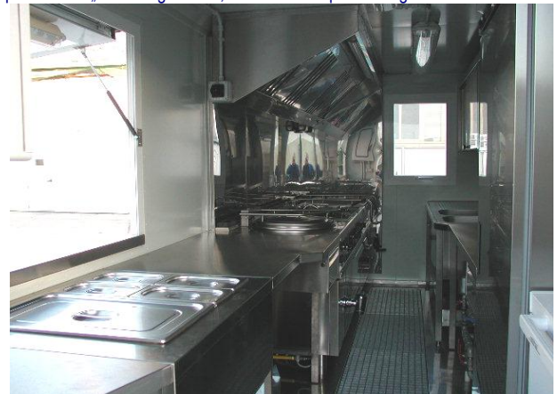
Innenansicht des Komplexes von der Eingangstür aus: links die Seite Kochen Verteilung rechts die Seite Spülbecken Kühlschränke
