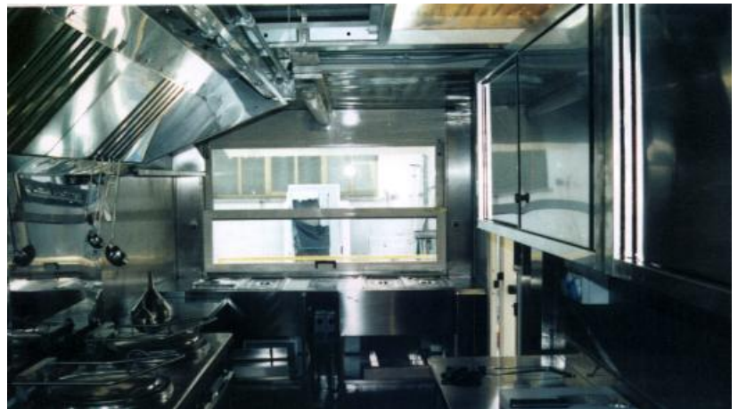
Innenansicht des Moduls in Richtung Verteilbereich
