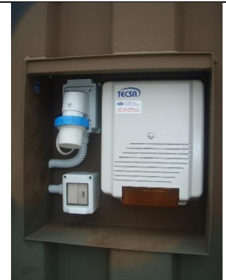
Außendetail mit: elektrischer Abzweigung, Alarmschalter – Einschalten Innenlicht und Sirene mit Blinklicht
