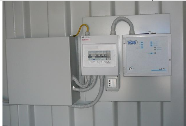
Innendetail Schalttafel und Alarmsteuereinheit
