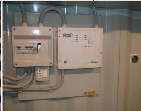
Innendetail Schalttafel und Alarmsteuereinheit
