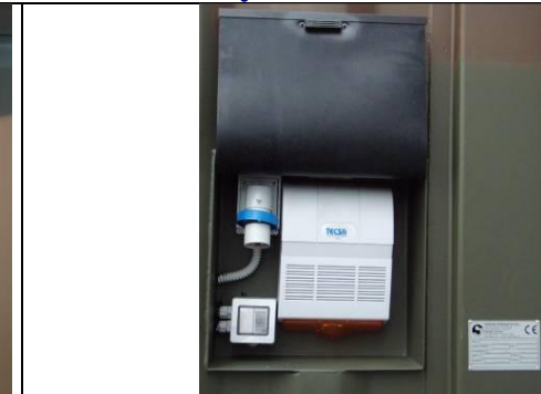
Außendetail mit: elektrischer Abzweigung, Alarmauslöser - Einschaltung Innenlicht und Sirene mit Blinklicht
