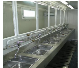
Ein Innenraum mit Waschbeckenbereich – alles aus Edelstahl
