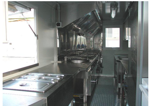
Vista interna del complesso dalla porta ingresso: a sx il lato cottura distribuzione e a dx il lato lavello frigoriferi
