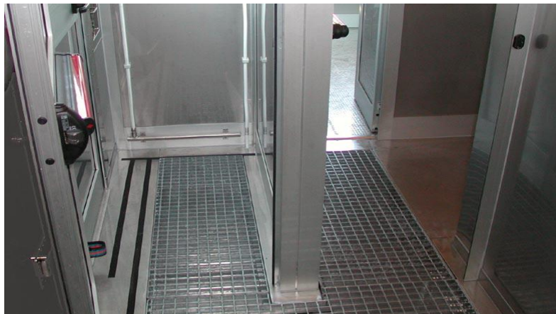
Dettaglio interno aree di passaggio utenti con vasche protette da grigliati
